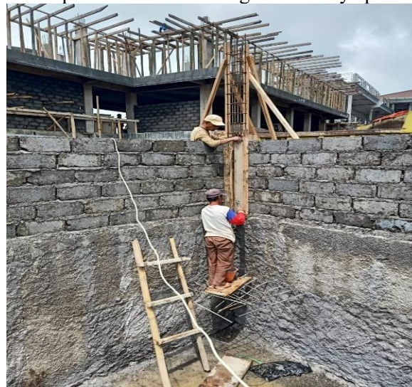
Gb.2. Proses pembastingan pada kolom GWT dengan kurangnya penerapan k3
