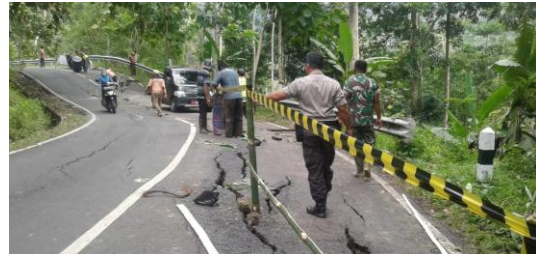
Gambar j. Kondisi jalur utama Kepil Wonosobo yang retak sebagai contoh kebutuhan pemeliharaan jalan dan jembatan.
