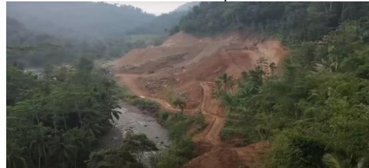
Gambar f. Bendungan Bener Purworejo sebagai contoh infrastruktur air berskala kawasan.
