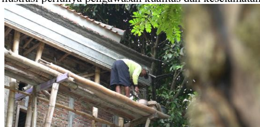
Gambar p. Aktivitas pekerja pada bagian atap bangunan sebagai ilustrasi pentingnya standar keselamatan kerja.
